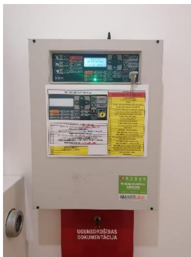
1. attēls. Automātiskās ugunsgrēka atklāšanas un trauksmes signalizācijas sistēmas kontrolpanelis.
